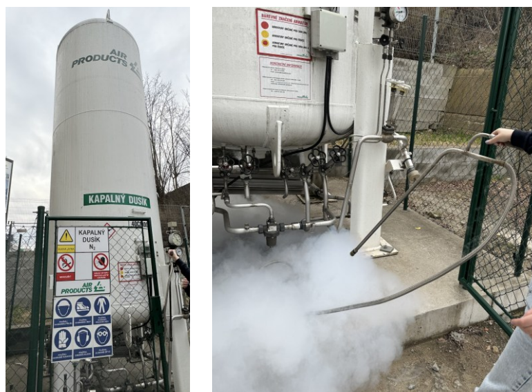
Obr. 2- 22 Kryogenní nádrž v Náškovu, vlastní foto
